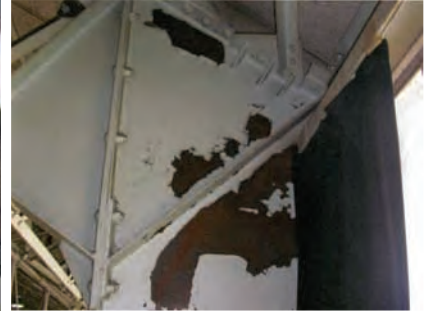
接合部の塗装剥がれ
