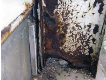
柱脚のウェブの断面欠損
