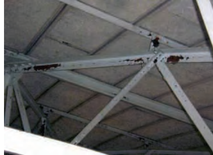
トラス材の塗装剥がれ
